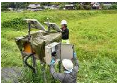
志楽川上流に設置された水位計
